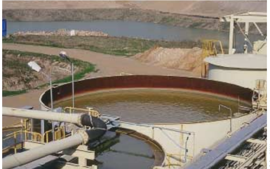
Tanklara alınan, öğütülmüş çamur halindeki cevhere burada siyanür ilavesi yapılıyor. Çözeltinin altın ya da gümüş içermeyen kısmı arıtma ünitesine gönderiliyor. Cevher içeren kısım, karbon adsorpsiyonu ve diğer işlemler için öteki tanklara aktarılıyor.
